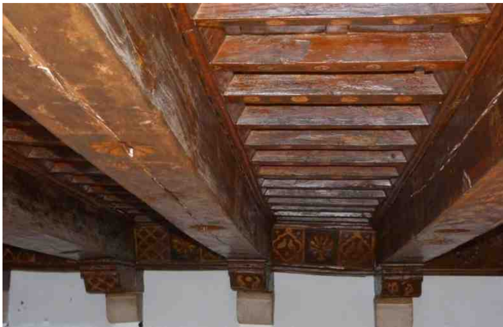
Imatge on observem les peces d'entrebega col·locades de manera obliqua, sobre caixa paredera
