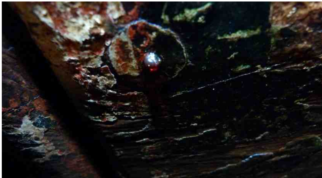
Acumulació de vernís de la darrera intervenció
